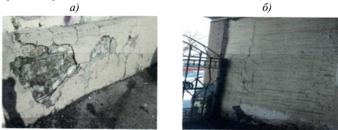
Рис. 1. Пошкодження фундаменту (а) та несучої цегляної стіни (б) будинку (тріщини шириною до 20 мм)
